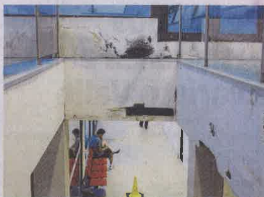
Algunos de los desperfectos en el 'pabellón verde'. ■ JOAQUÍN BILBAO
