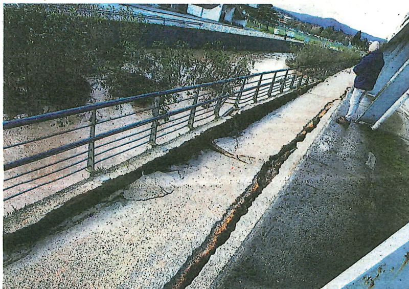
Parte del tramo dañado de la senda del Piles. | Ángel González
